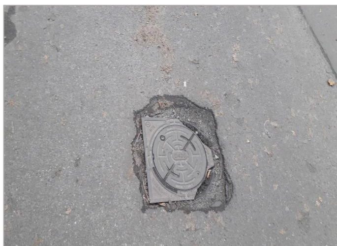
❗ Obr. 1.26 Teleskopický poklop šachty DN315 poškozený z důvodu nedostatku rovnoměrné a trvalé podpory.
