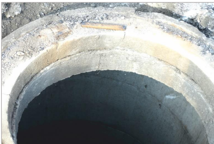
Obr. 4.42 Degradace konstrukce podírající poklop. Kus výztuže jako vyrovnávací prvek způsobuje bodový destruktivní tlak.
