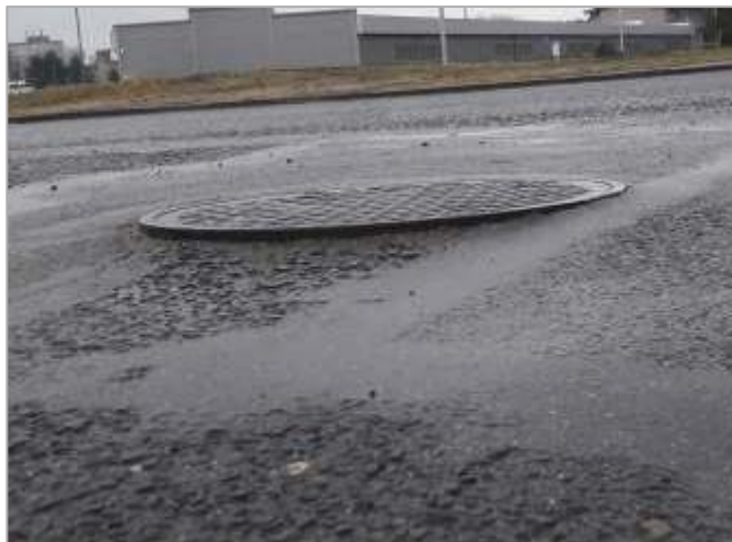
Obr. 1.33 Poklop vyvýšený nad povrch vozovky v důsledku jejího poklesu
