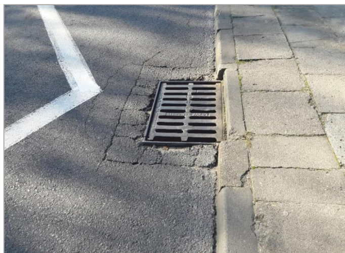
Obr. 1.27 Porušené okolí uliční vpusti. Nevhodná poloha – cyklické pojíždění autobusů. Povrchové trhliny se vyvinuly díky nedostatečnému podložení vpusti a díky netěsnostem v tomto podložení.
