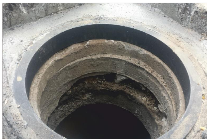
❗ Obr. 14 Nesprávná poloha prstenců (nedostatečné vycentrování), nedostatek správné podpory mezi prvky
