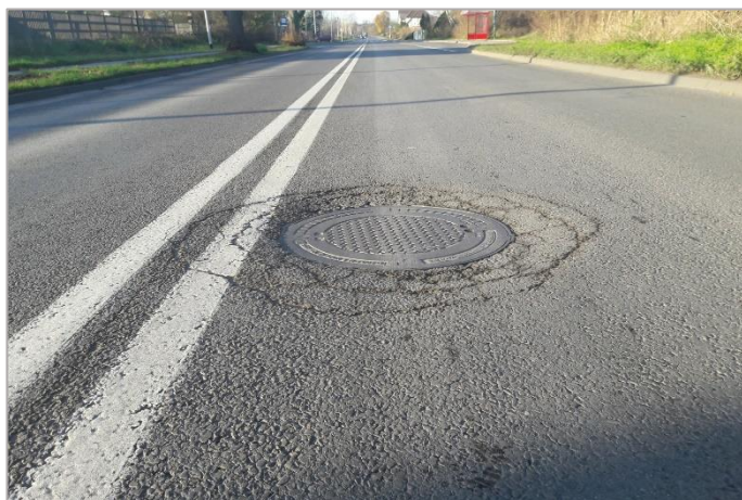
Obr. 1.32 Poklop kanalizační šachty je umístěn přímo v linii pojezdu kola vozidla. Dopravní zatížení Kr. 2-3. Degradace podpůrných prvků poklopu, poškození základu a praskání povrchu vozovky. (Kr. 2 – 13-70 pojezdů jízdního pruhu nákladními automobily se zatížením osy 100 kN za den, Kr. 3 – 71– 335 přejezdů za den, polské předpisy).
