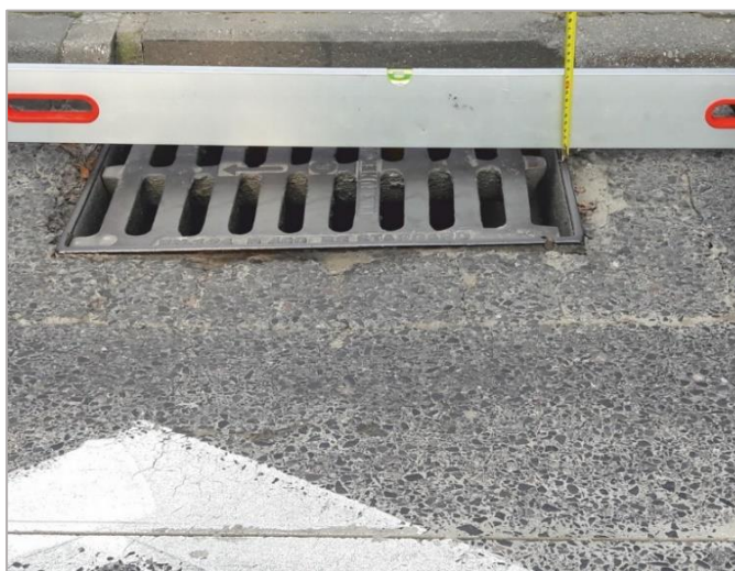
Obr. 1.28 Ověření technického stavu vpustí. Zapadnutá vpust. Pokles roštu v rámu.
