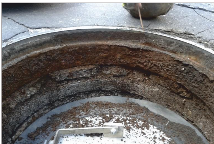
Obr. 4.41 Degradace konstrukce podírající poklop. Betonové malty rozpadlé, prasklé vyrovnávací prstence. Nedostatečná únosnost a těsnost zhlaví šachty.
