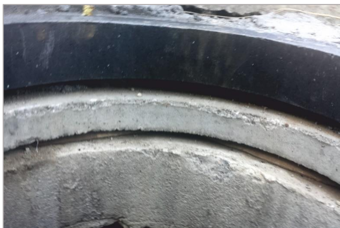
❗ Obr. 1.13 Nepříjemné provedení – nedostatek podpory pro vyrovnávací prstence a adaptéry. Zakončení nezajišťuje nosnost, těsnost a bezpečnost konstrukce!
