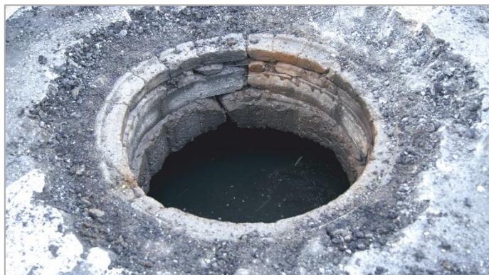
1 Obr. 1.10 Intenzivní opotřebení zhlaví šachty. Úplná degradace vyrovnávacích prstenců, betonové spojovací a vyrovnávací malty, praskliny krycí desky. Sanace není možná bez výměny poškozené krycí desky šachty.
