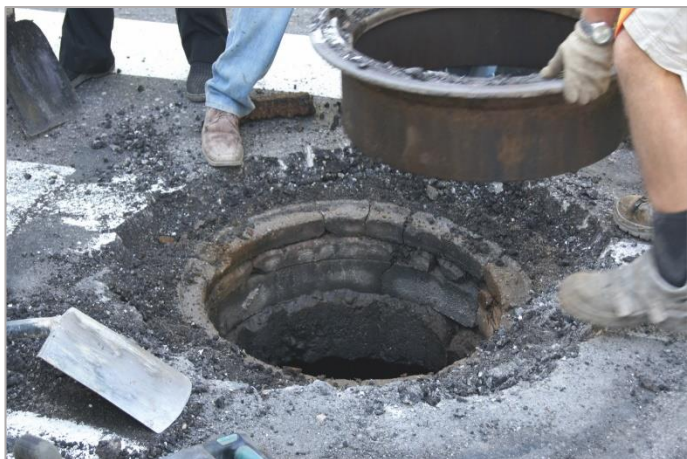
Obr. 1.36 Odstranění rámu samonivelačního poklopu s menším povrchem rámu (cca 1 600 cm 2 ) namontovaným přímo na betonové prvky! Nepříznivé podmínky prostředí. Životnost 1,5 roku.
